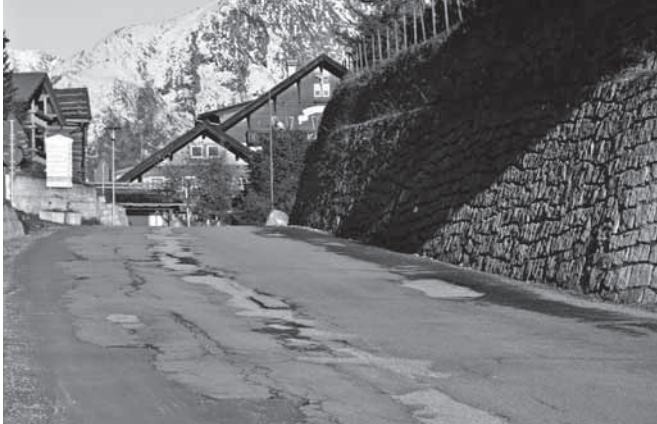
Erbärmlicher Straßenzustand in Kasern vor der Asphaltierung
