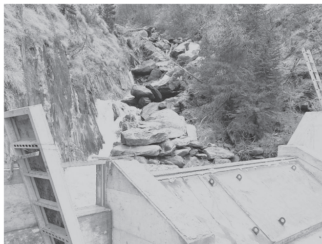
Einlauf Wasserfassung am Röttalbach
